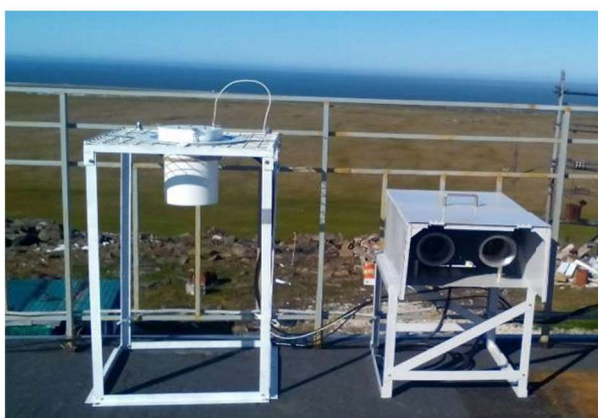
Рисунок 3.6 – Установка выносных блоков измерителей «Поле-2М» и «Электропроводность-2М» на:
