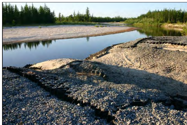
Рис. 13. Разрушение береговой линии р. Малая Хадырьяха в месте пересечения ее трубопроводом, Береговой ЛУ (фото автора)
