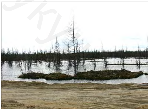
Рис. 12. Гибель растительности вследствие подтопления территории из-за строительства дороги, Береговой ЛУ (фото автора)
